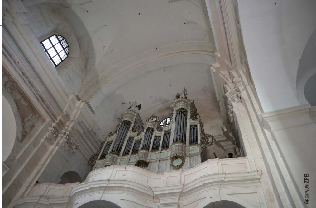
ORGANY W BUDZŁAWSKIM KOŚCIELE. NA SKLEPIENIU I ŚCIANACH WIDOCZNE SĄ ŚLADY PO POŻARZE. LIPIEC 2026 R.
